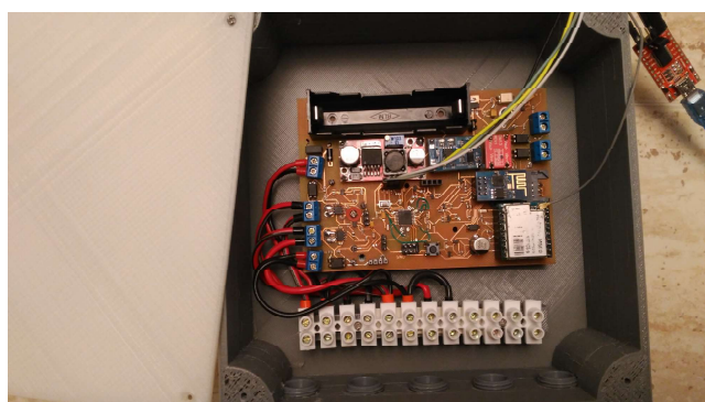
Figura 17. Resultado del sistema desarrollado una vez finalizadas las soldaduras y montado en la caja realizada mediante impresión 3D.
