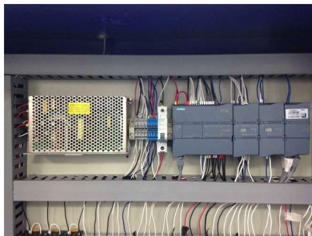
Fig. 10. Instalación PLC en el tablero eléctrico
