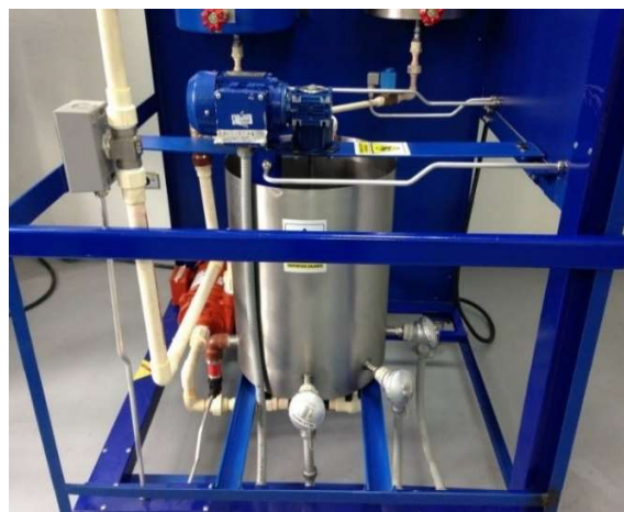
Fig. 3. Sensores de temperatura instalados
